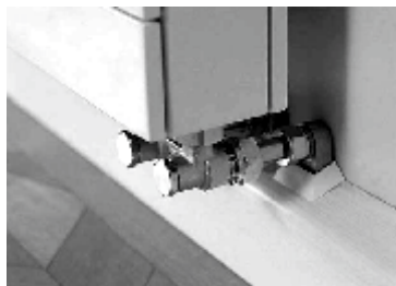
Рис. 151 Декорування трубопроводу опалення коробом
